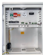
PREDISPOSTO PER ALTRI SWITCH
